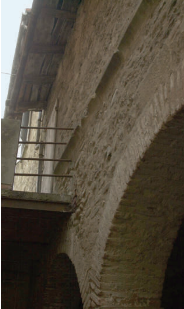
Il cornicione di quel che resta dell'antico palazzo di Sibano (foto M. Molinari).
