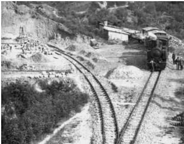
Un binario provvisorio della ferrovia Direttissima in costruzione arriva direttamente a una cava di pietra usata per la costruzione della linea. (foto FS da: i treni oggi - 38).
