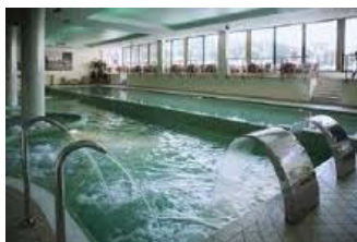
Impianti di utilizzo
